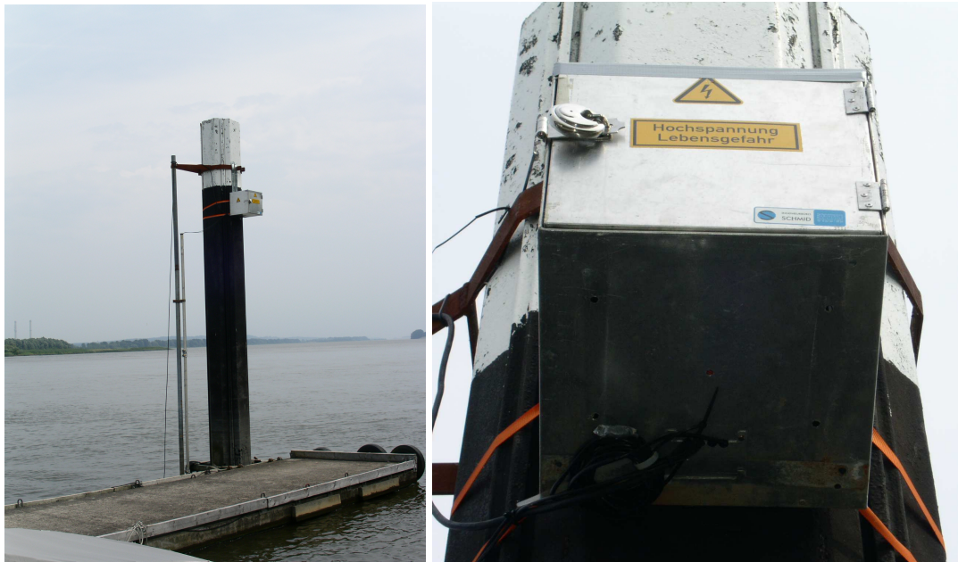
Abb. 3: links: Messstation am Dalben; rechts: Messkasten
