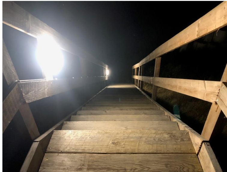
Die Treppenbeleuchtung entsprach nicht den Vorgaben. Das Foto zeigt die Beleuchtungssituation an der Treppe zur BE-Fläche Nordseite.
