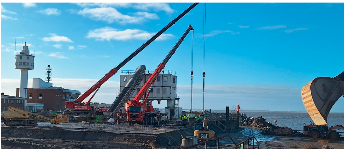
Raum gewonnen: Mit dem Rückbau des großen Betonmischwerks werden 5.500 Quadratmeter Fläche frei.
