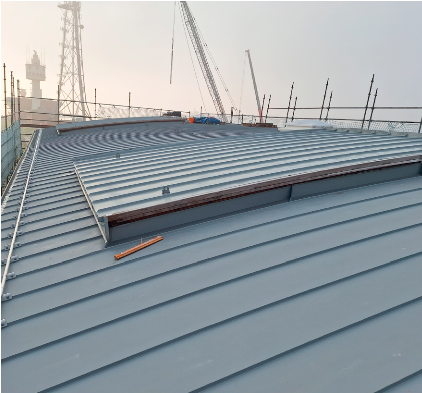
Montageöffnungen auf dem Dach des Torhauses: Durch sie wird später die Antriebstechnik per Kran abgelassen.
