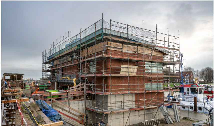
Im Torhaus finden die Arbeiten von Elektroingenieuren, Elektrotechnikern und weiteren Spezialisten im Inneren statt.
