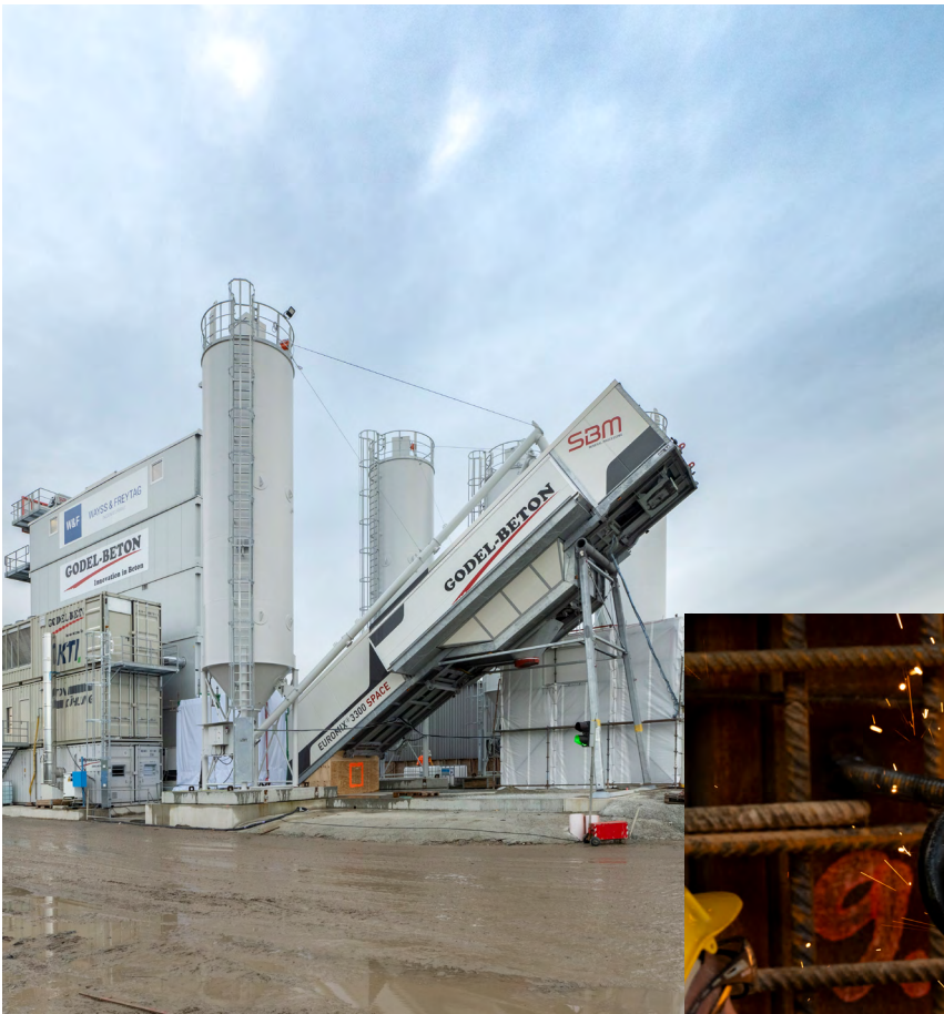
Um den Beton aufzunehmen, positionieren sich die Fahrmischer unter der rund 45 Grad geneigten Übergabeeinrichtung.
