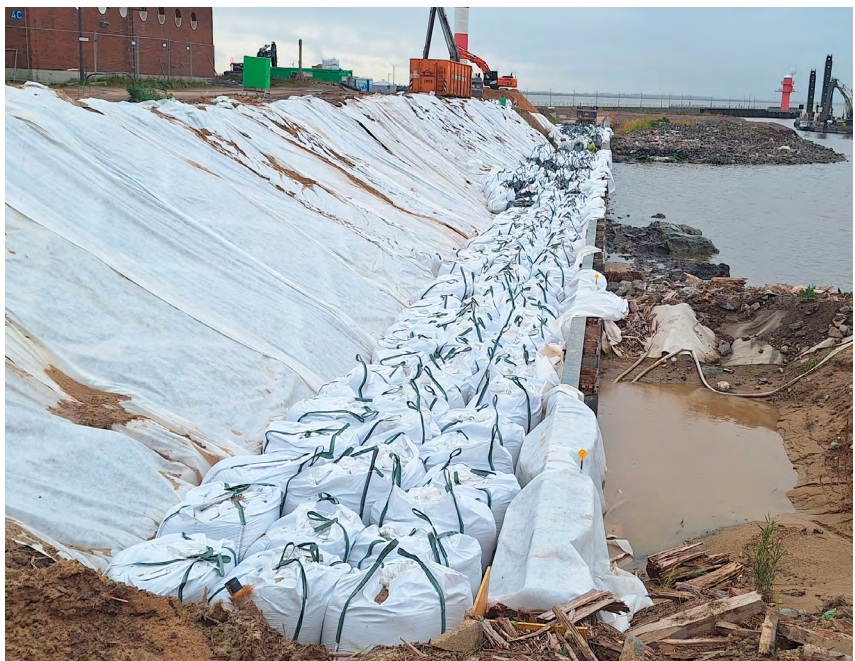
Im Bereich des neuen Vorhafens wird die temporäre Böschung vor Witterung und Erosion geschützt.
