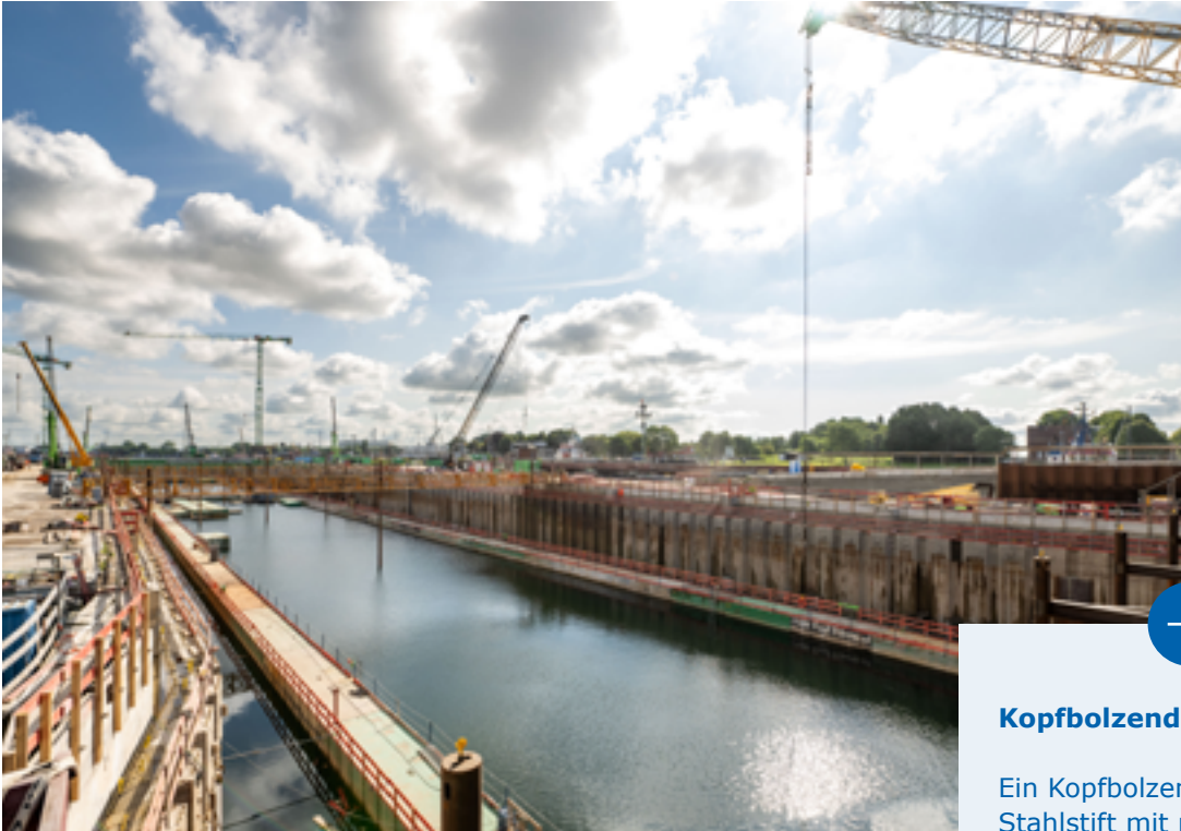
Sichtbare Wände: Dank des abgesenkten Wasserstands können die Arbeiten an den Kammerwänden beginnen.
