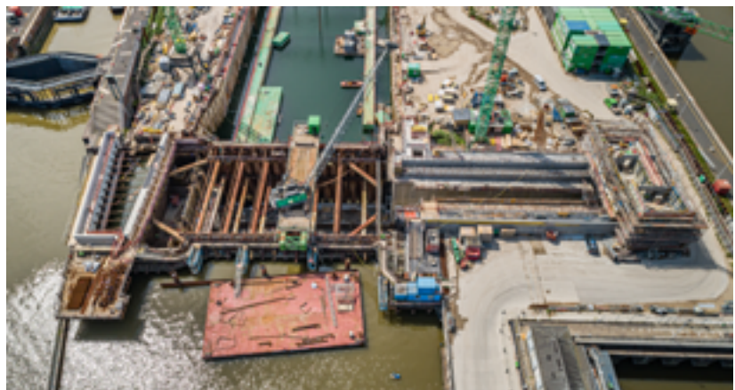
Blick auf die Baugrube des Binnenaupts: rechts die Torkammer mit dem Rohbau des Torhauses.
