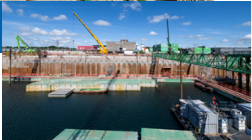
Von Pontons aus werden die Spundwände für die Betonage der Vorsatzschalen vorbereitet.
