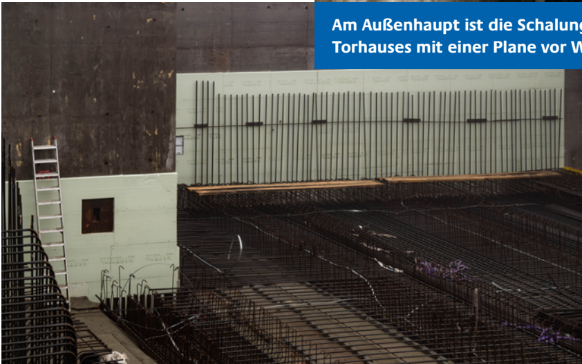
Die Stützwand dient dazu, den Geländesprung zwischen der Schleusendeckshöhe von 6,50 über NHN und dem niedrigeren Vorhafen abzufangen.
