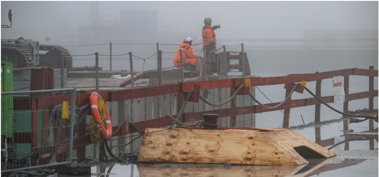
Auf der Baustelle haben die von uns beauftragten Firmen der ARGE die nächsten Meilensteine fest im Visier.
