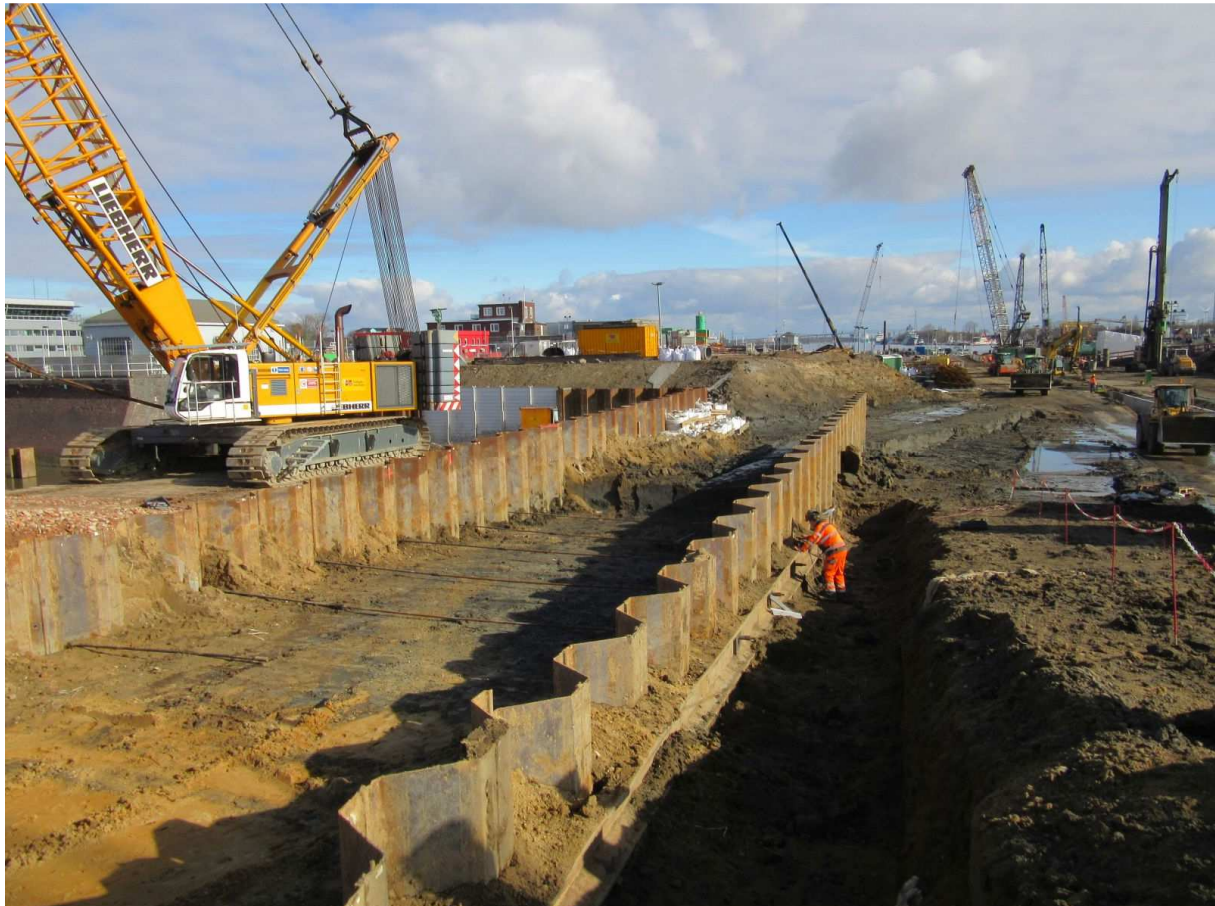
Zwischen zwei Spundwänden wird die Baustraße auf den neuen Deich geführt (März 2018).
