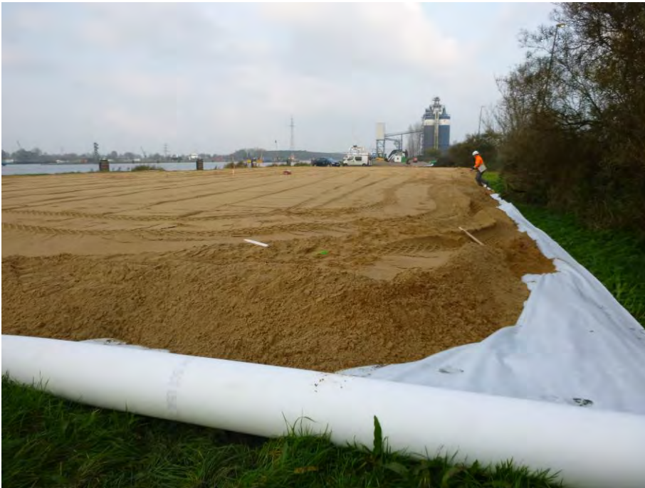
Abb. 3 Auf der BE erfolgt der Einbau einer Sandschicht auf einem geotextilen Vlies.
