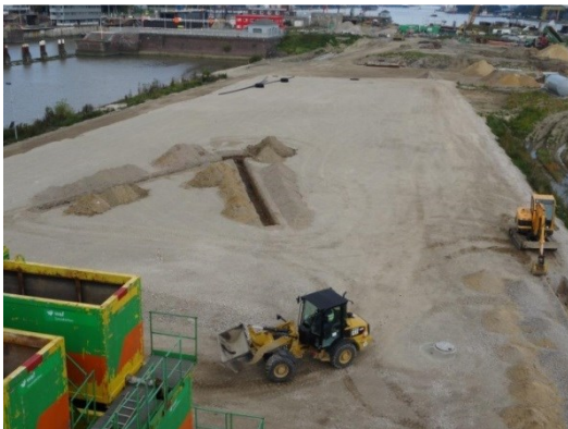
Blick auf die Arbeitsebene der Betonmischanlage
