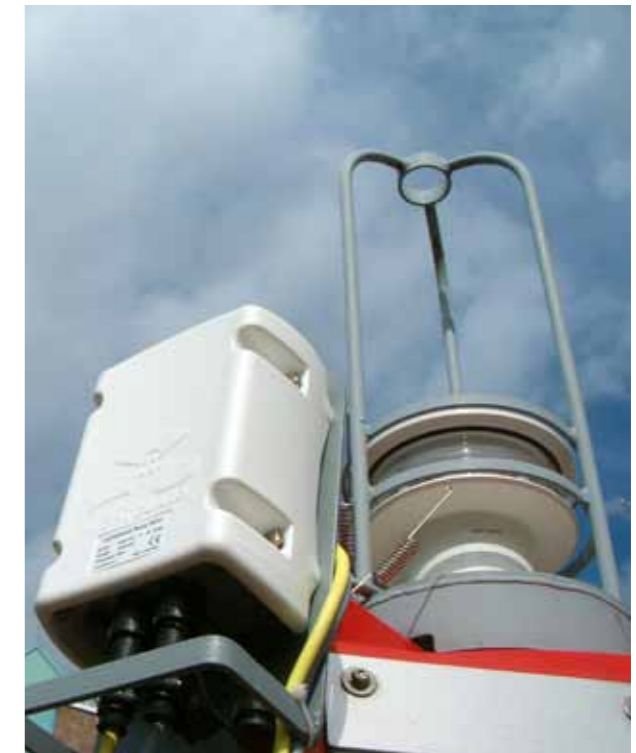
Abb. 2: Synchronisationsmodul wird zwischen Laterne und Stromversorgung zwischengeschaltet
