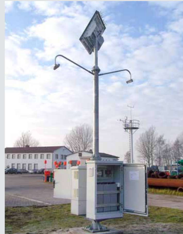
Abb. 1: Kombinierte Energieerzeugung aus Photovoltaik und Brennstoffzelle
