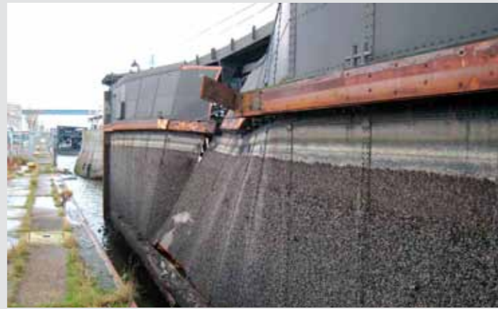
Abb. 4: Havariertes (angefahrenes) Schiebetor
