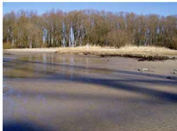
Abb. 6: Ufer vor Instandsetzung des Deckwerks, kaum Bewuchs und fortgeschrittener Uferabbruch
